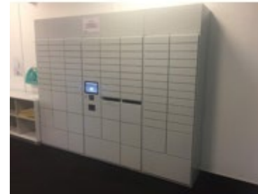
Anlage in Haus 1
