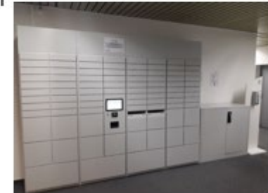
Anlage in Haus 2
